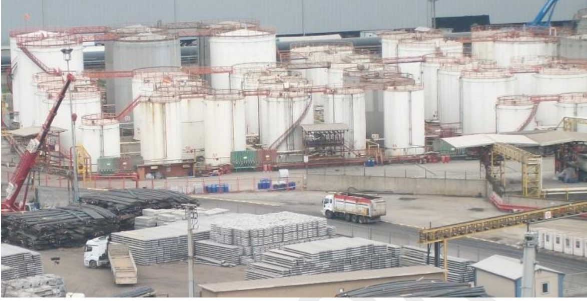
Şekil 2 Tesisin Dış Görünüşü 1
